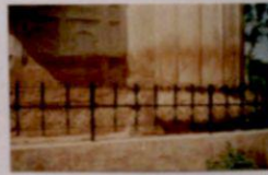
MOISTURE SPOILING THE BASE. : DOERDI, RAMBAGH.
