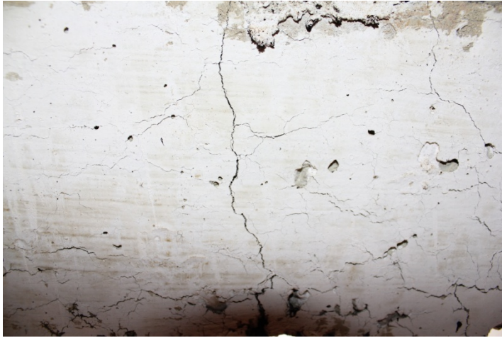
Fig.3.12. Thermal cracking in slab soffit
