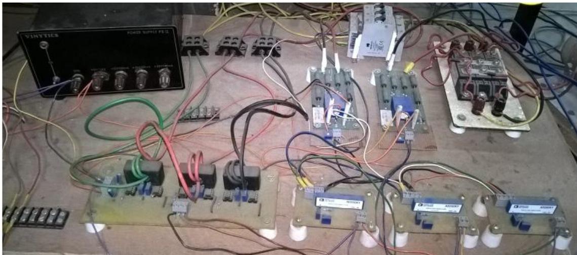
Fig. A 3.4 Sensors, Rectifier and RPS
